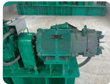
故障した電動機
