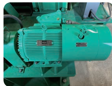
更新した電動機
